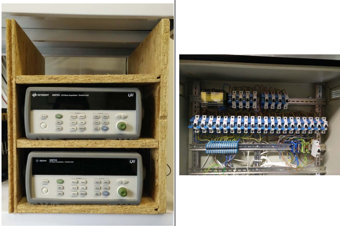
Abbildung 58: Messtechnik (Links: Datenlogger vom Typ 34972A / Rechts: Schaltkasten zur Ansteuerung der Komponenten)
