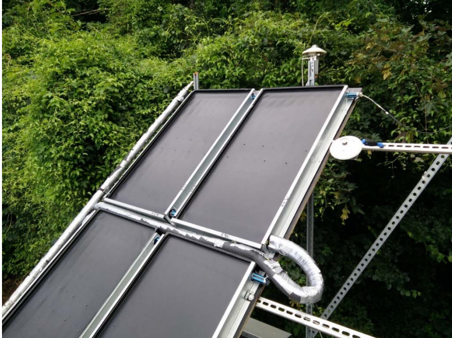
Abbildung 79: Unabgedeckte Kollektoren zu Beginn der Thermographie-Messung
