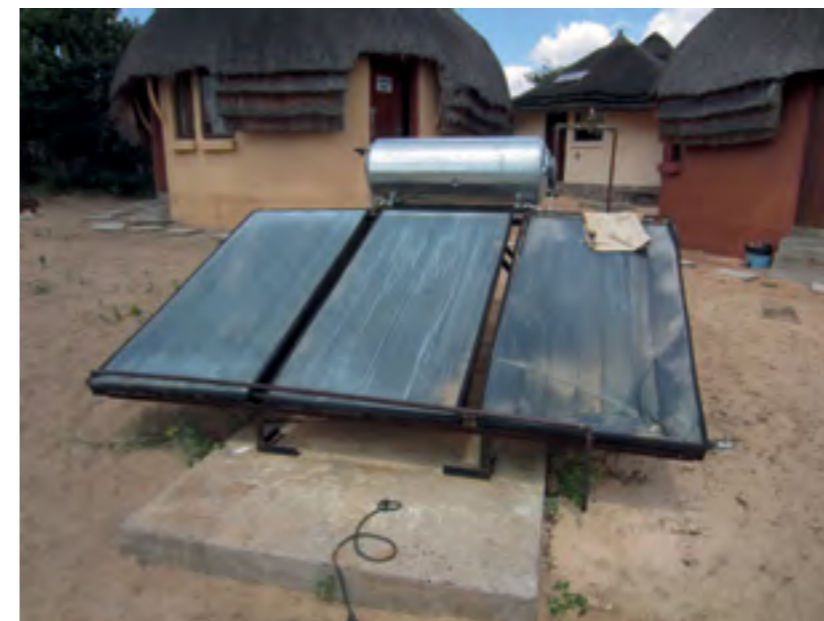
Abb2b: Im südlichen Afrika fehlt vielerorts das Wissen zur Instandhaltung von Anlagen zur Erzeugung regenerativer Energien, wie diese Abbildung eines beschädigten Solarkollektors zeigt.
